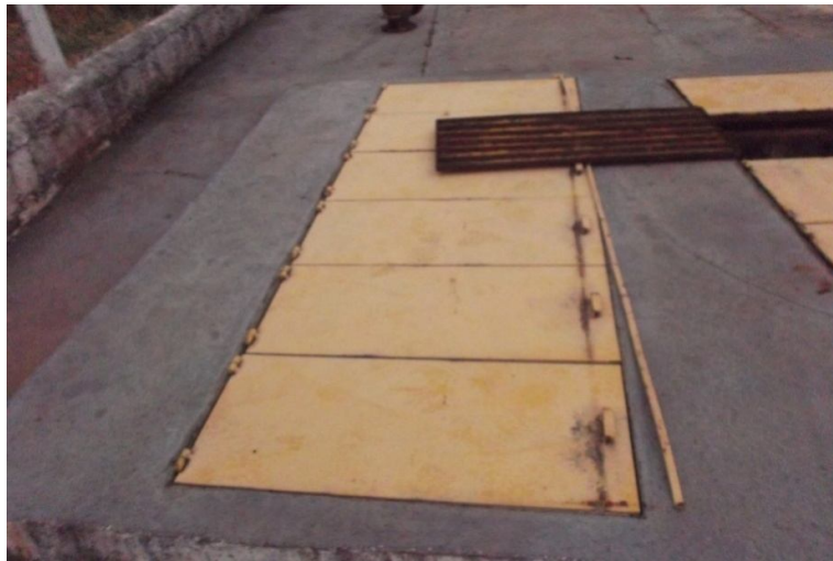
Figura 51 – Dimensões das tampas metálicas: 6 unidades de 108 x 228 cm com trava para cadeado, conforme Figura 56
