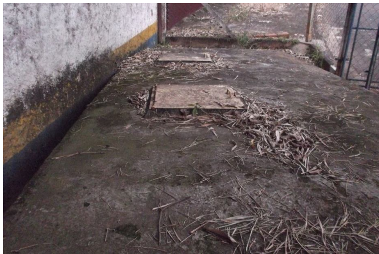
Figura 30 - Vista Geral das 2 (duas) tampas danificadas
