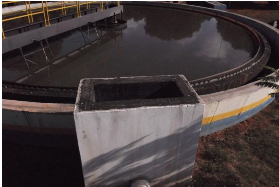
Figura 77 – Foto da caixa de passagem do Decantador4
