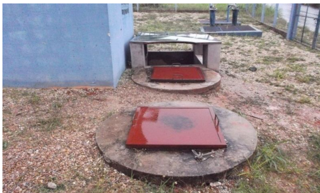
Figura 39 - Vista Geral da 2 (duas) tampas metálicas danificadas
