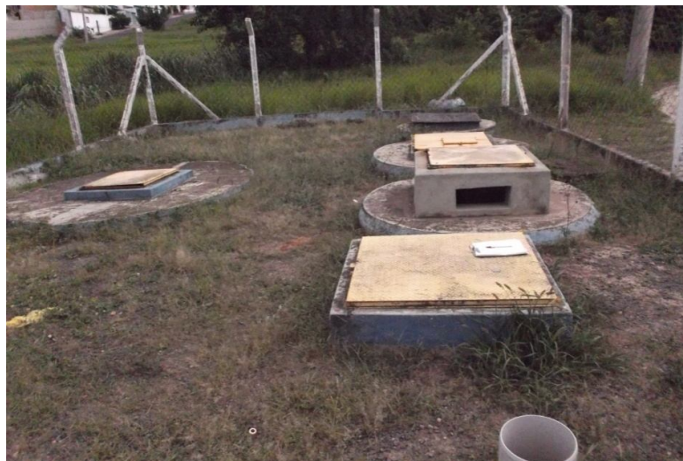
Figura 22- Vista geral das tampas metálicas danificadas
