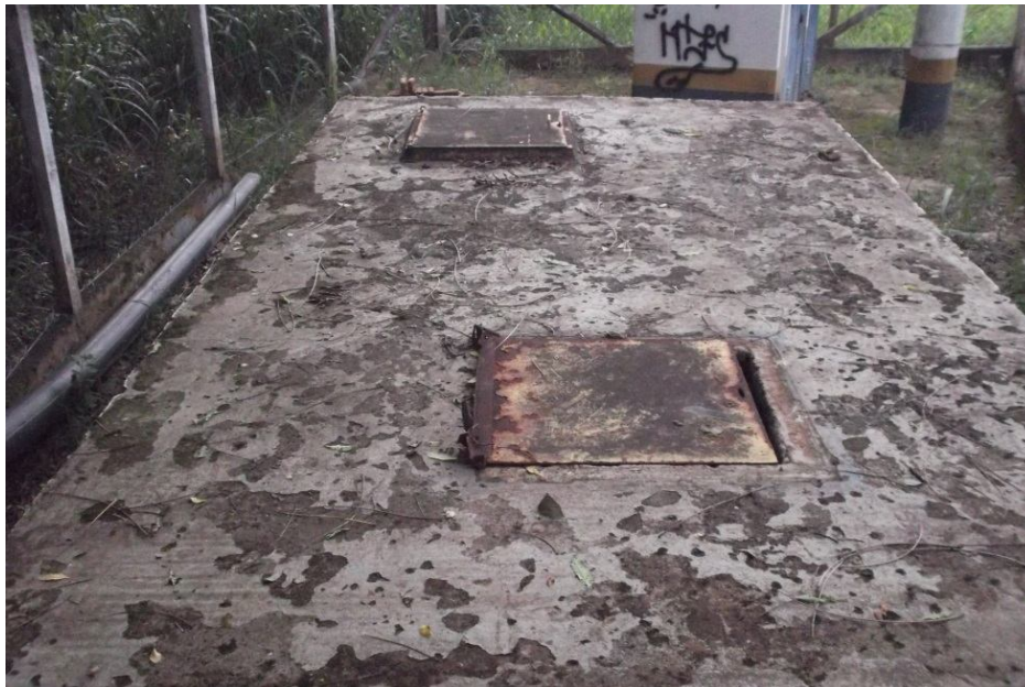
Figura 26 - Vista Geral das 2 (duas) tampas metálicas danificadas
