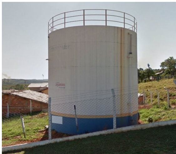
Figura 84– Foto da local para reforma do guarda corpo e da escada de acesso do Reservatório de Água Tratada Pinheiros.
