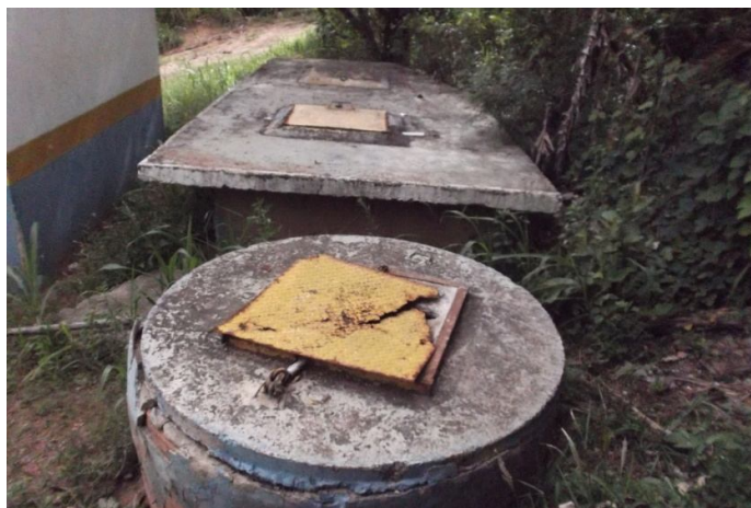
Figura 36 - Vista Geral das 3 (três) tampas metálicas danificadas
