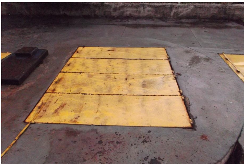
Figura 57 – Dimensões das tampas metálicas: 1 conjunto de 4 unidades, totalizando 220 cm x 170 cm com trava para cadeado, conforme Figura 56
