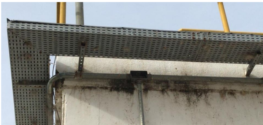
Figura 88: Foto da local - Suporte eletrocalhas
