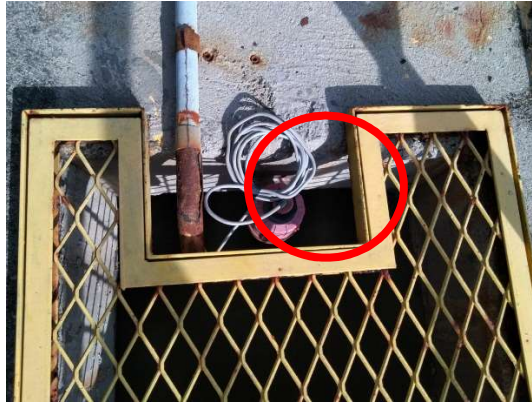
Figura 38: Foto da Estação Elevatória de Esgoto da ETE Vila Primavera contendo o transmissor de nível
