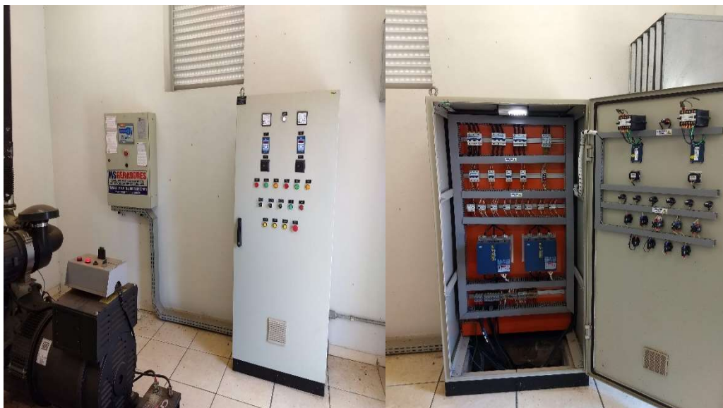
Figura 243: Estação Elevatória de Esgoto Bruto – EEEB 05 – Roseira de Cima.
