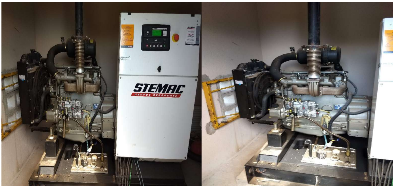
Figura 132: Estação Elevatória de Esgoto Bruto – EEEB Pacífico Moneda II.
