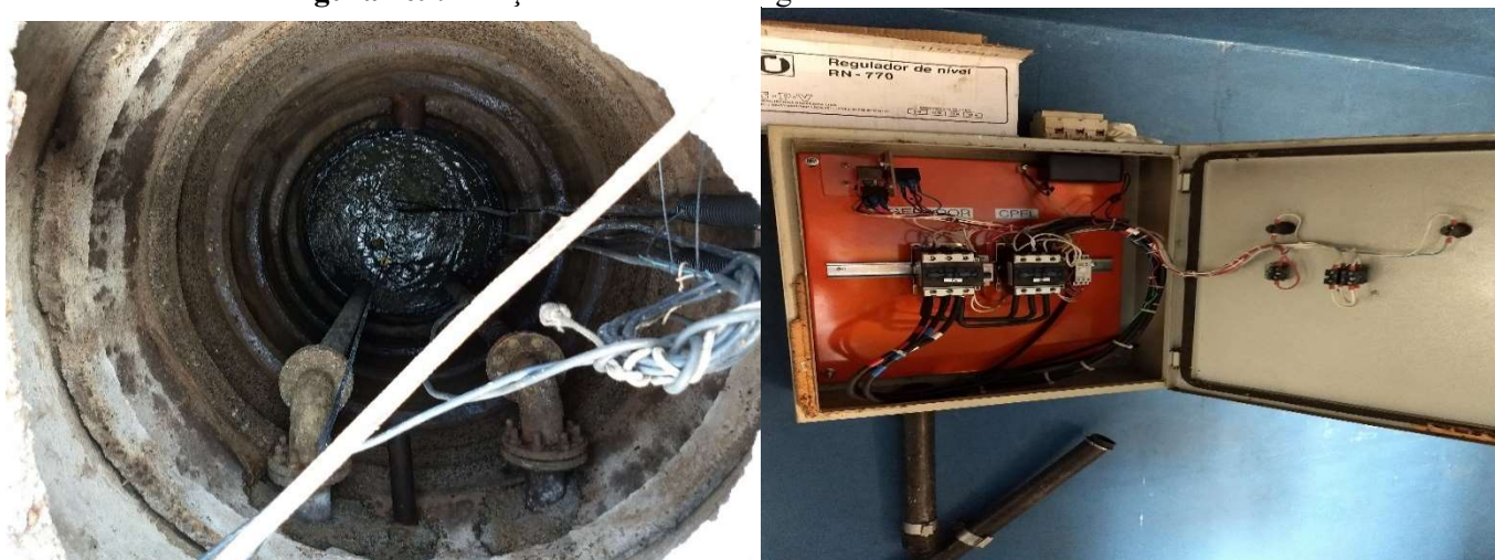
Figura 109: Estação Elevatória de Esgoto Bruto – EEEB Reserva da Barra.
