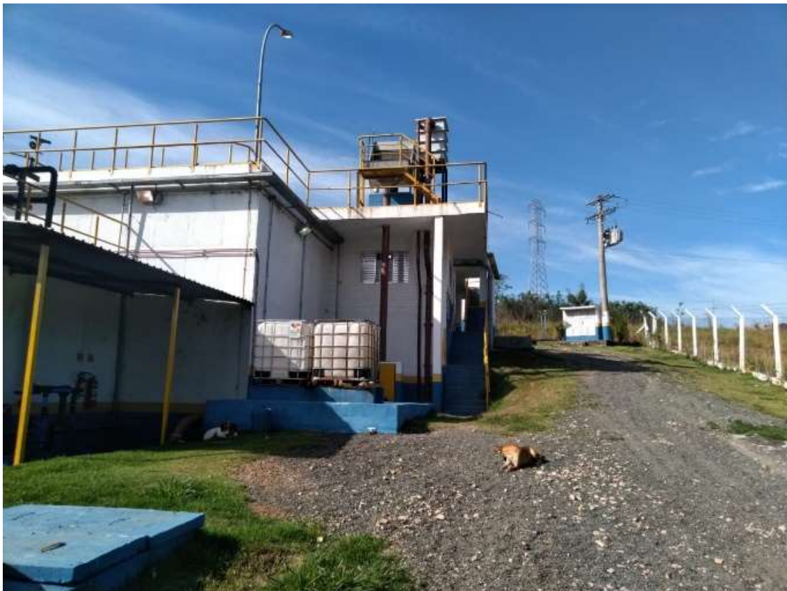
Figura 11: Imagens ETE (Estação de Tratamento de Esgoto) Vila Primavera.
