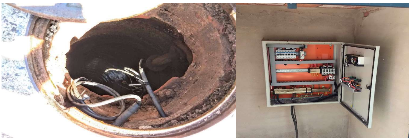
Figura 186: Estação Elevatória de Esgoto Bruto – EEEB Colina do Castelo II.
