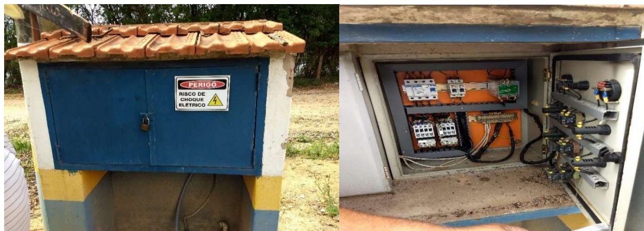
Figura 102: Estação Elevatória de Esgoto – Guedes B (EEE – Guedes II).
