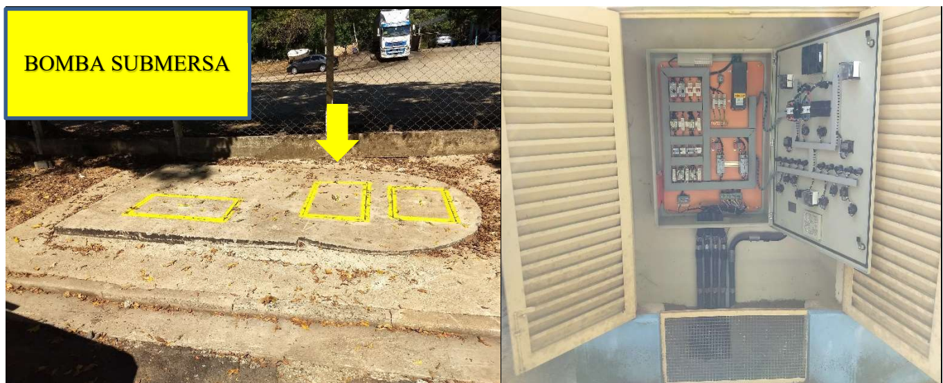
Figura 176: Estação Elevatória de Esgoto Bruto - EEEB 03A.
