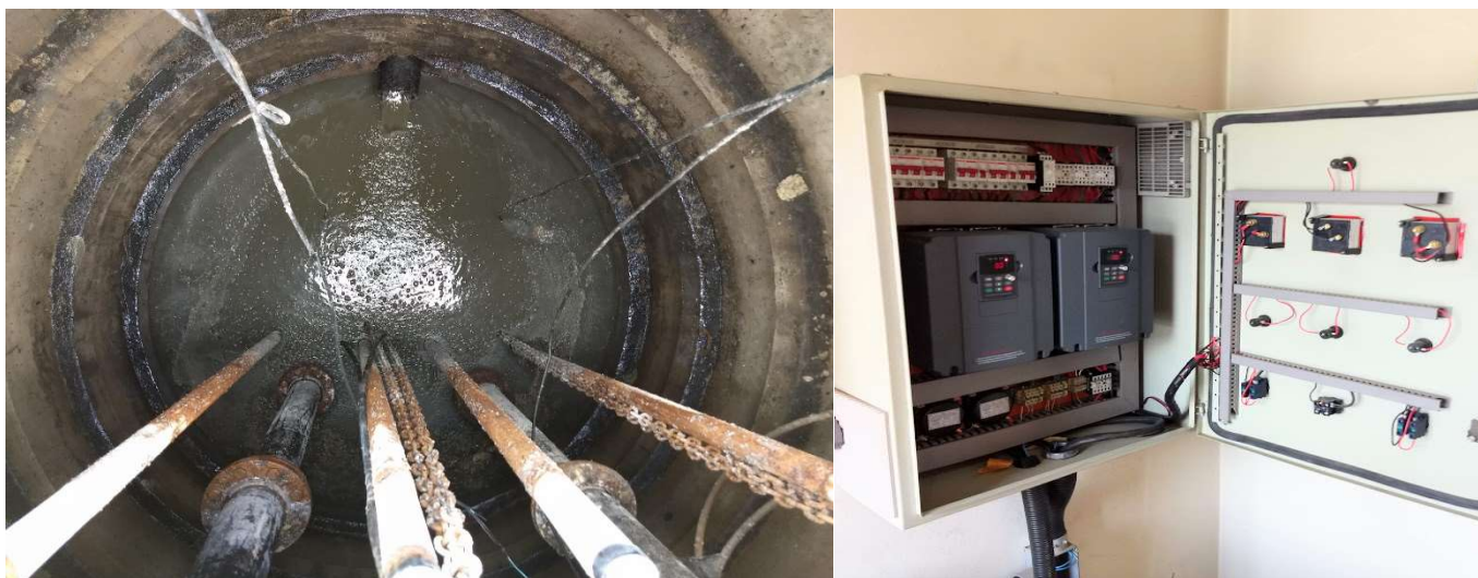
Figura 94: Estação Elevatória de Esgoto – Guedes I (EEE – Guedes I).
