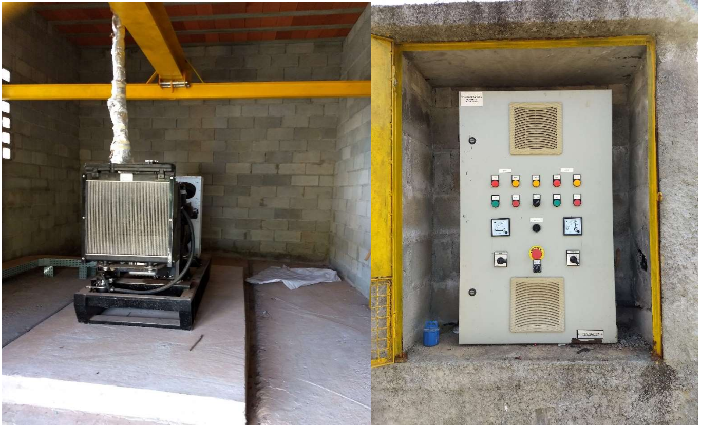
Figura 269: Estação Elevatória de Esgoto Bruto – EEEB Vila Primavera.
