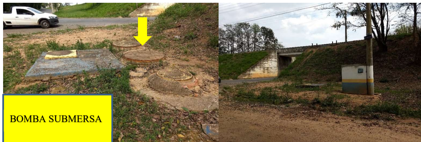
Figura 101: Estação Elevatória de Esgoto – Guedes II (EEE – Guedes II).
