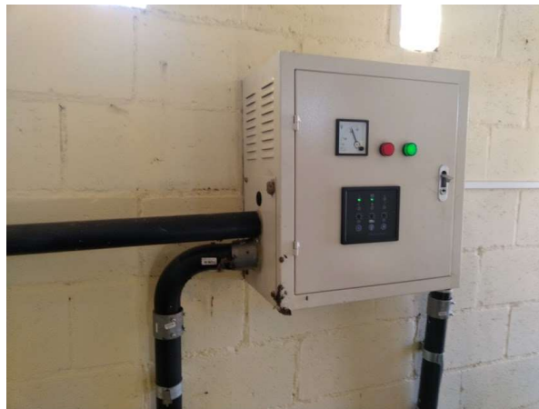
Figura 234: Painel ATS do Grupo MotoGerador da EEEB Águas do Jaguari.
