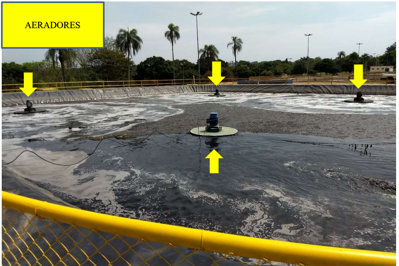
Figura 53: Imagens ETE Jaguariúna (Estação de Tratamento de Esgoto) – Aerador superficial e bóia de apoio para aerador superficial.
