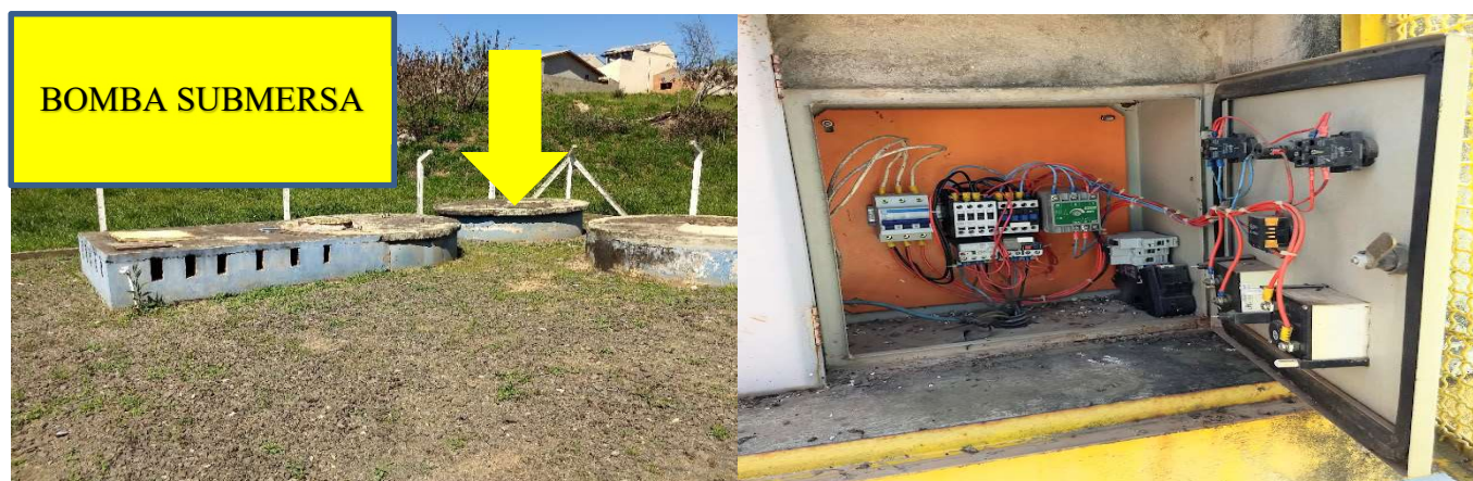
Figura 161: Estação Elevatória de Esgoto Bruto – EEEB Nova Jaguariúna III
