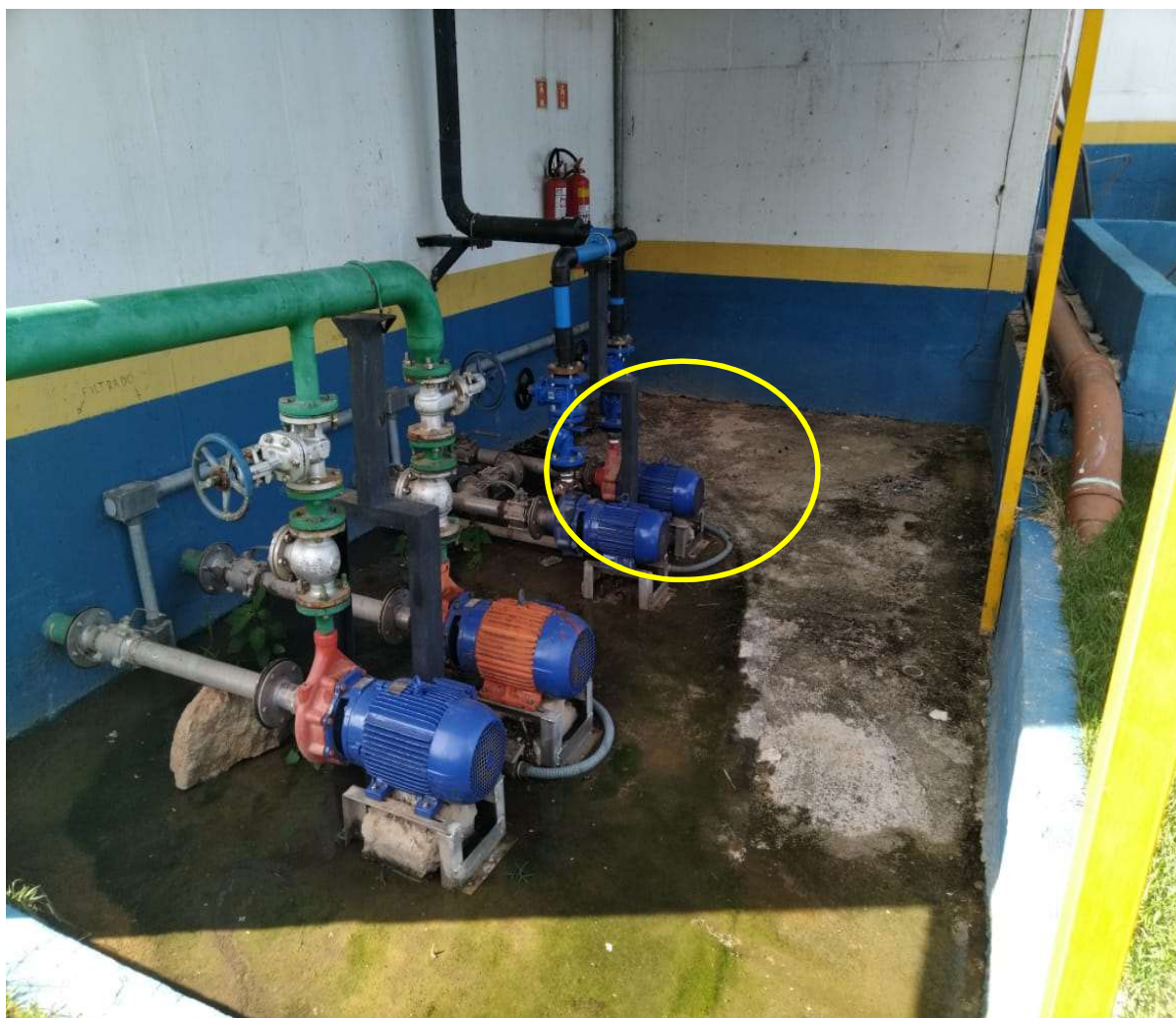
Figura 23: Foto dos Conjuntos de Moto bombas centrífugas da Filtração
