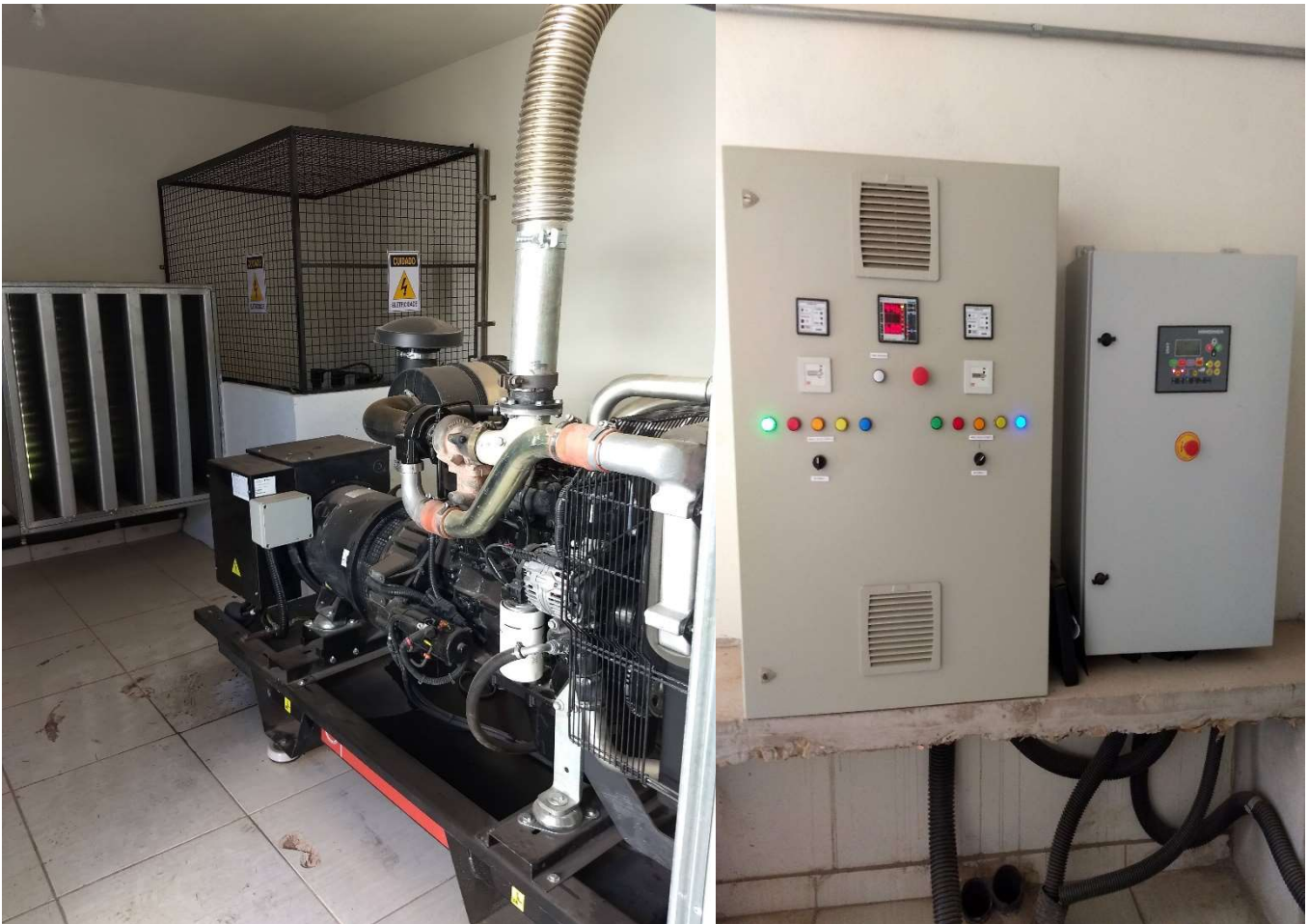
Figura 171: Estação Elevatória de Esgoto Bruto – EEEB 03.
