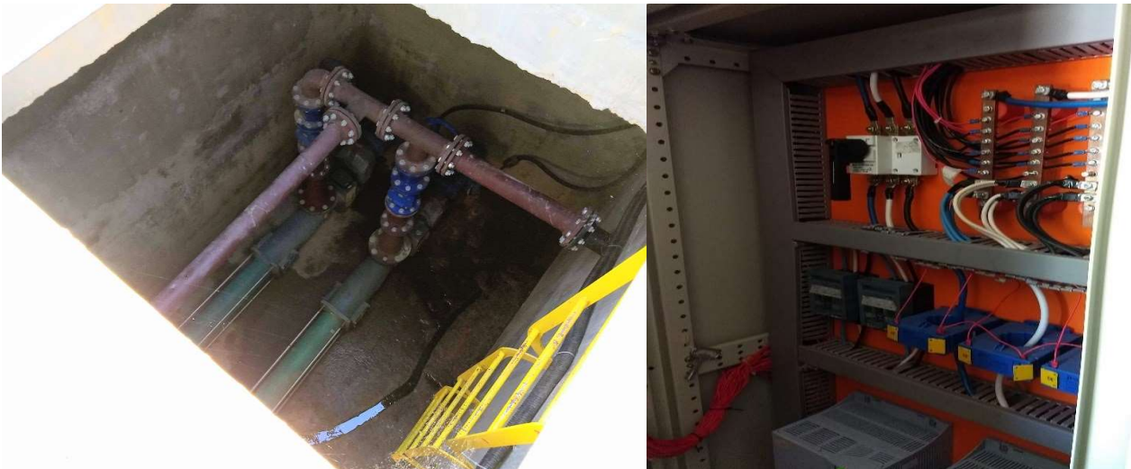
Figura 274: Estação Elevatória de Esgoto Bruto – EEEB Capela do Santo Antônio.
