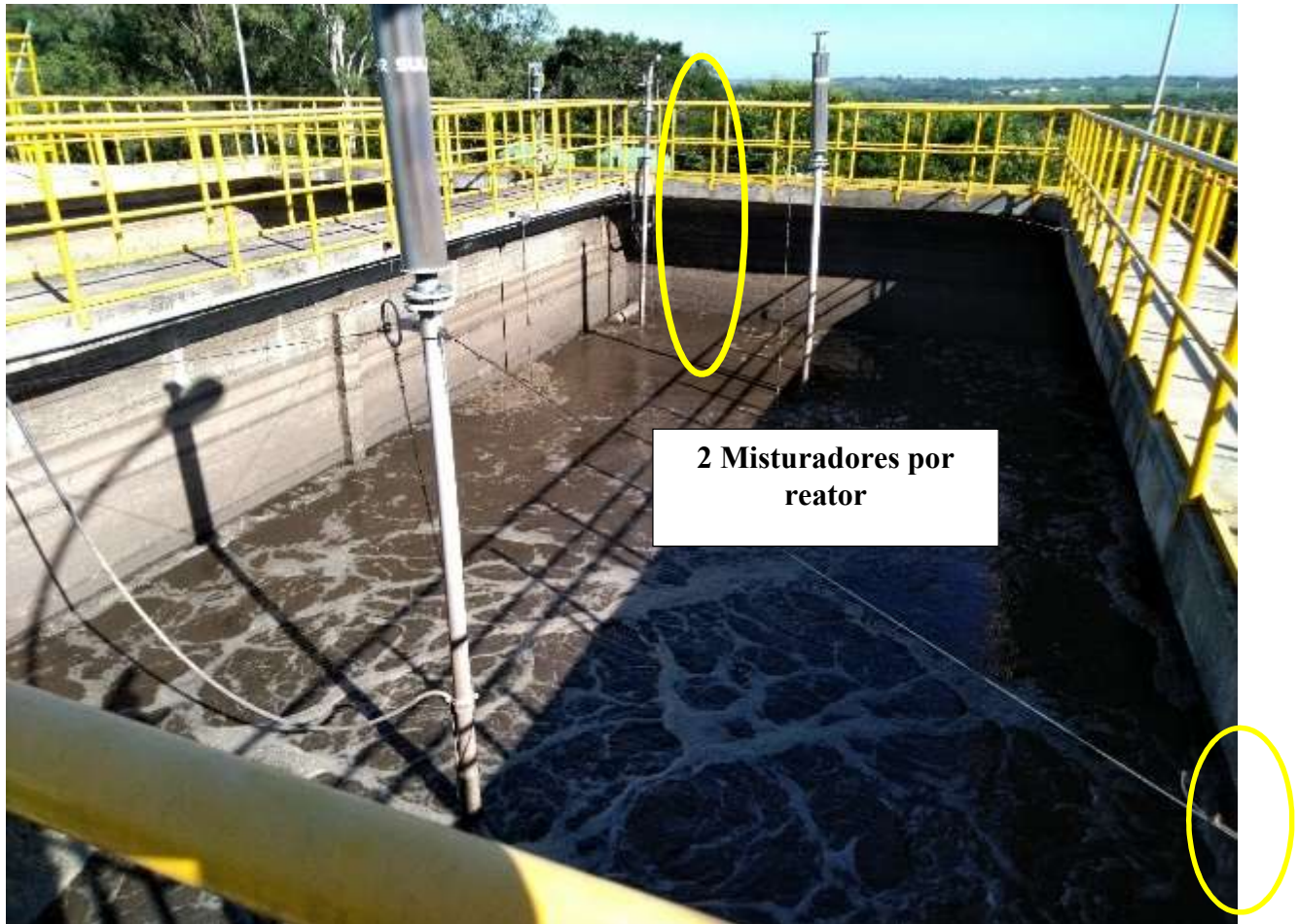
Figura 18: Foto dos misturadores instalados no reator 1 e 2.
