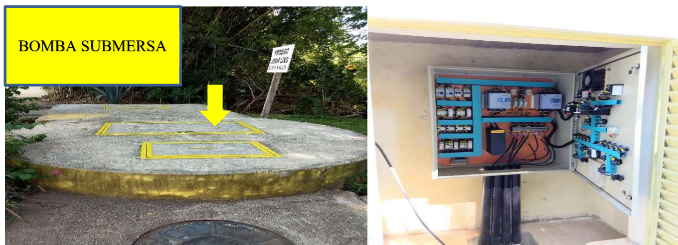
Figura 189: Estação Elevatória de Esgoto Bruto - EEEB 03 C
