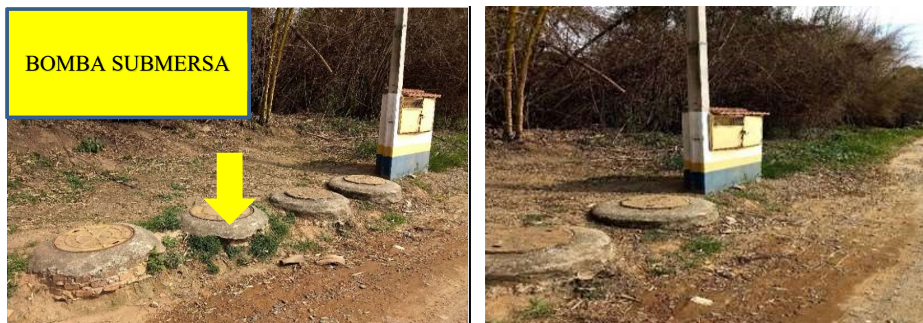
Figura 137: Estação Elevatória de Esgoto Bruto – EEEB Camanducaia.
