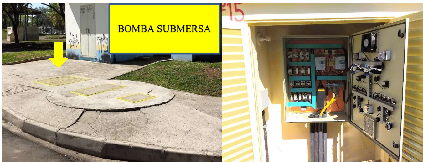
Figura 200: Estação Elevatória de Esgoto Bruto - EEEB 04.
