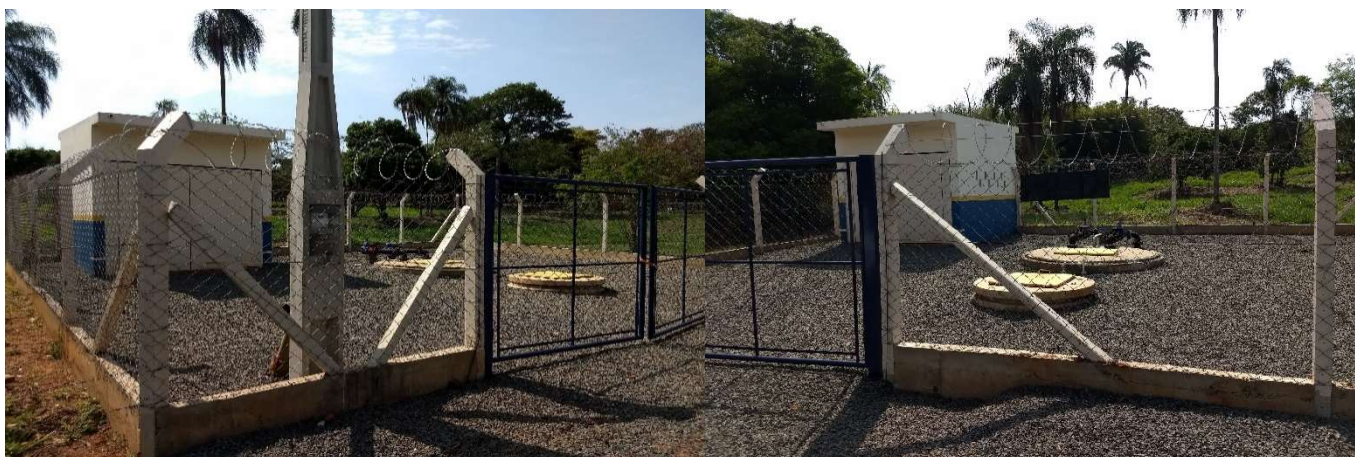
Figura 93: Estação Elevatória de Esgoto – Guedes I (EEE – Guedes I).
