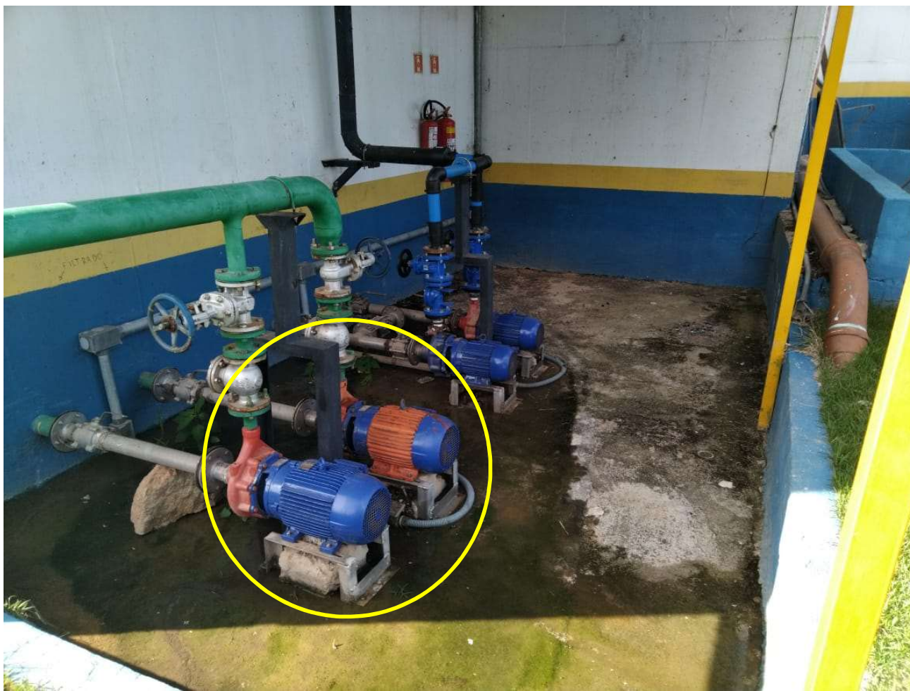
Figura 25: Foto dos Conjuntos de Motobombas centrífugas do Recalque de Esgoto Tratado
