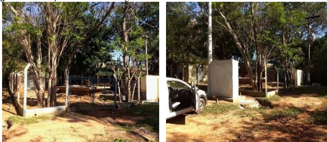
Figura 171: Estação Elevatória de Esgoto Bruto - EEEB Chácaras Primavera.
