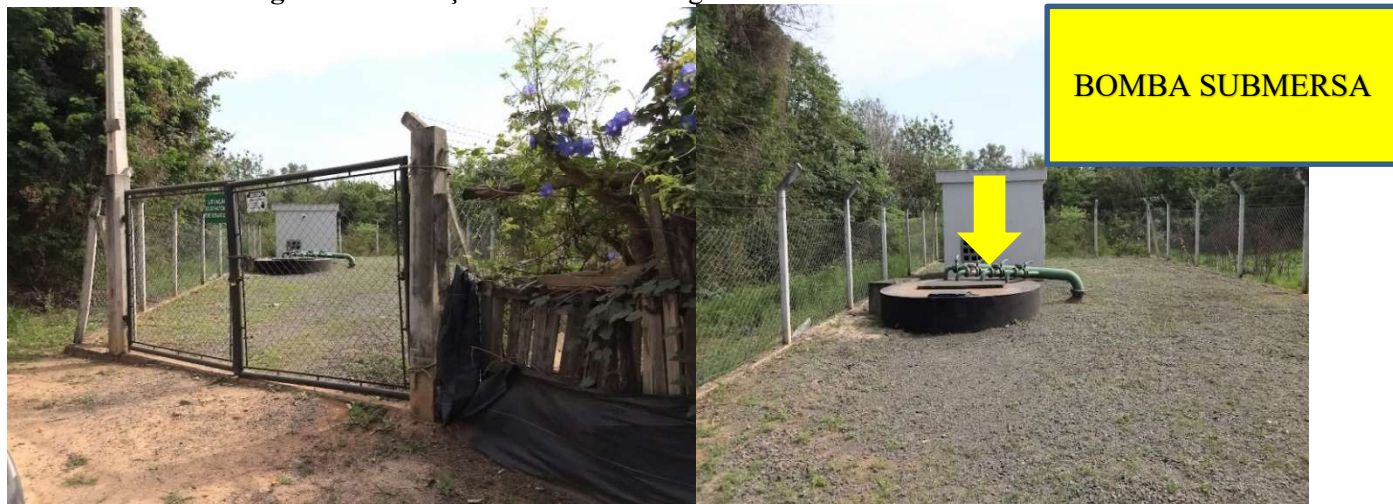
Figura 125: Estação Elevatória de Esgoto Bruto – EEEB Pacífico Moneda II.
