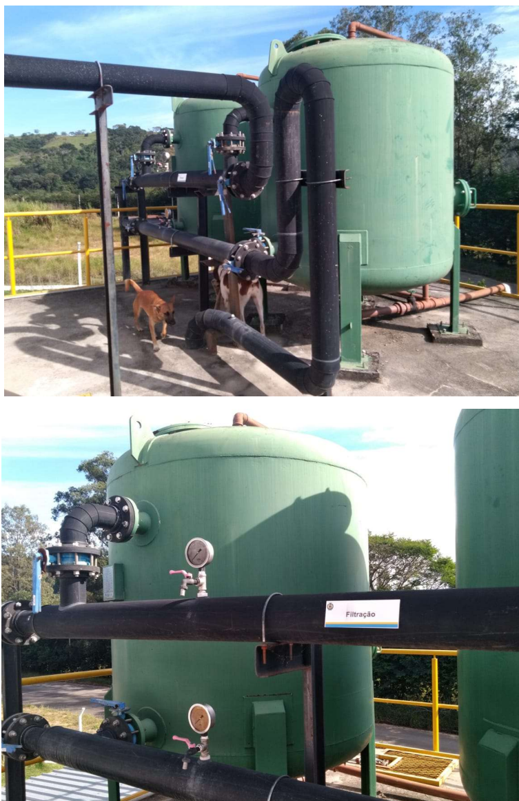
Figura 35 : Fotos dos filtros de areia da ETE Vila Primavera
