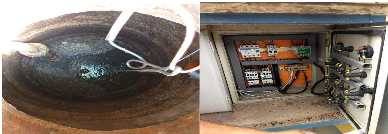
Figura 104: Estação Elevatória de Esgoto – Guedes III (EEE – Guedes III).
