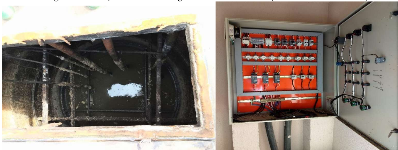
Figura 126: Estação Elevatória de Esgoto – Pacífico Moneda II (EEE – Pacífico Moneda II).
