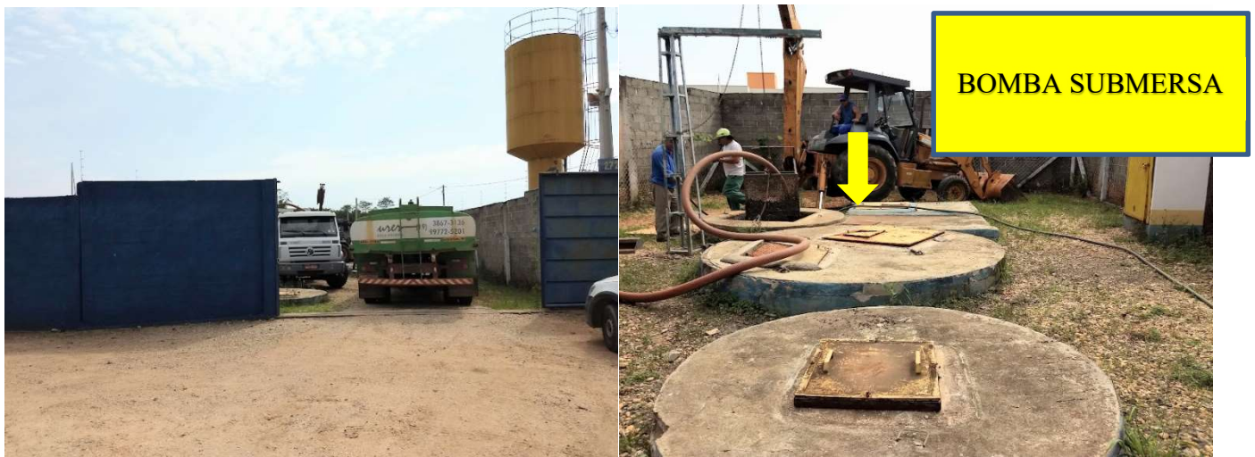
Figura 120: Estação de Elevatória de Esgoto Bruto – EEEB Jardim São Pedro.
