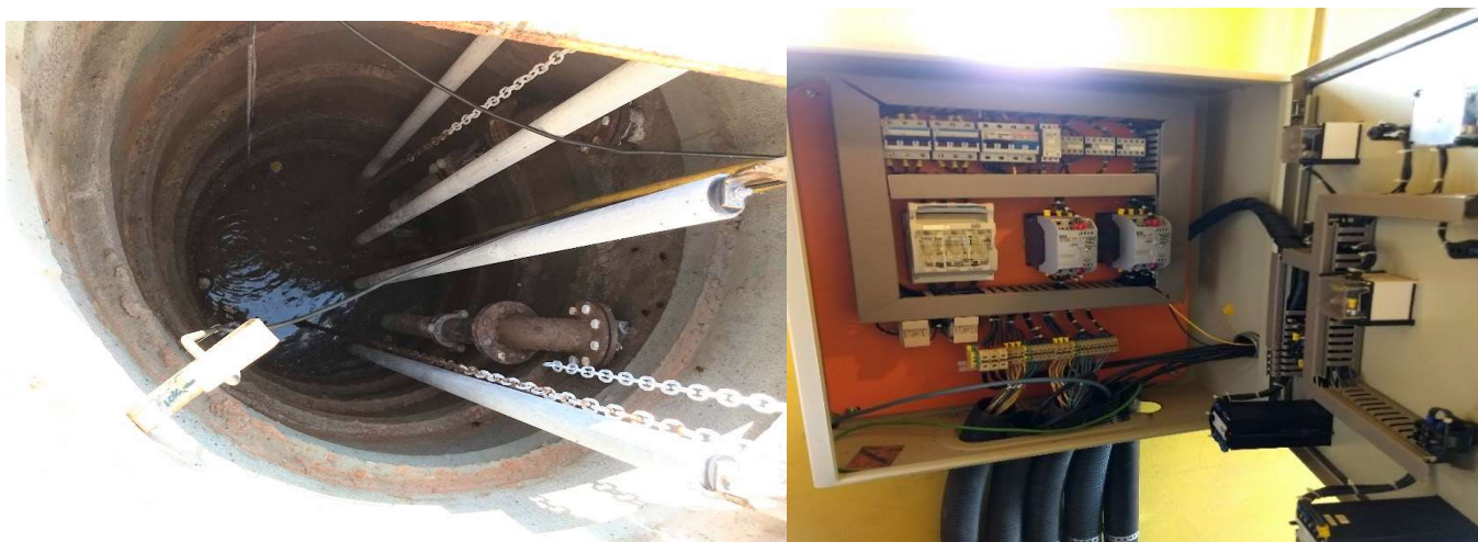
Figura 158: Estação Elevatória de Esgoto Bruto – EEEB Coração de Jesus.
