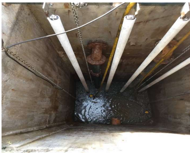
Figura 143: Estação Elevatória de Esgoto Bruto – EEEB Recanto dos Lagos.
