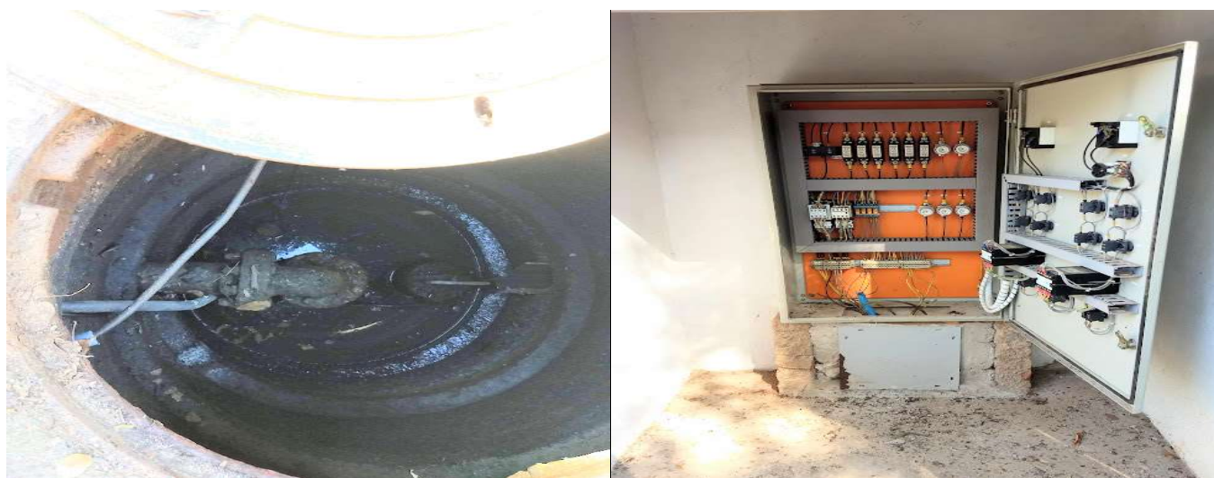
Figura 224: Estação Elevatória de Esgoto Bruto - EEEB Roseira de Cima III.
