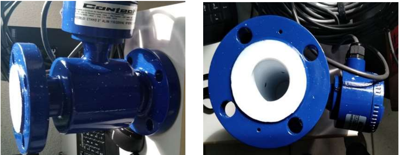
Figura 47: Ilustração do medidor de vazão da marca Contech instalado na ETE Vila Primavera.
