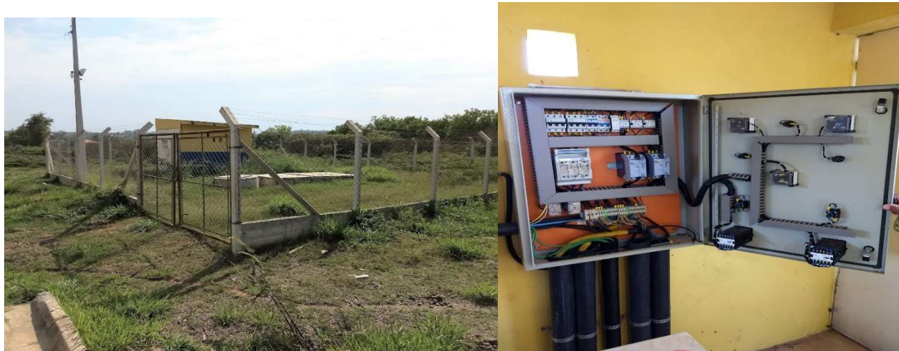
Figura 142: Estação Elevatória de Esgoto Bruto - EEEB Recanto dos Lagos.
