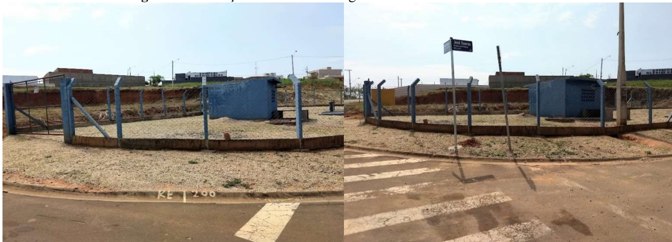
Figura 108: Estação Elevatória de Esgoto Bruto – EEEB Reserva da Barra.
