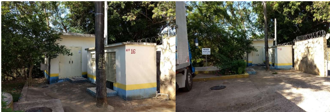
Figura 188: Estação Elevatória de Esgoto Bruto - EEEB 03 C.
