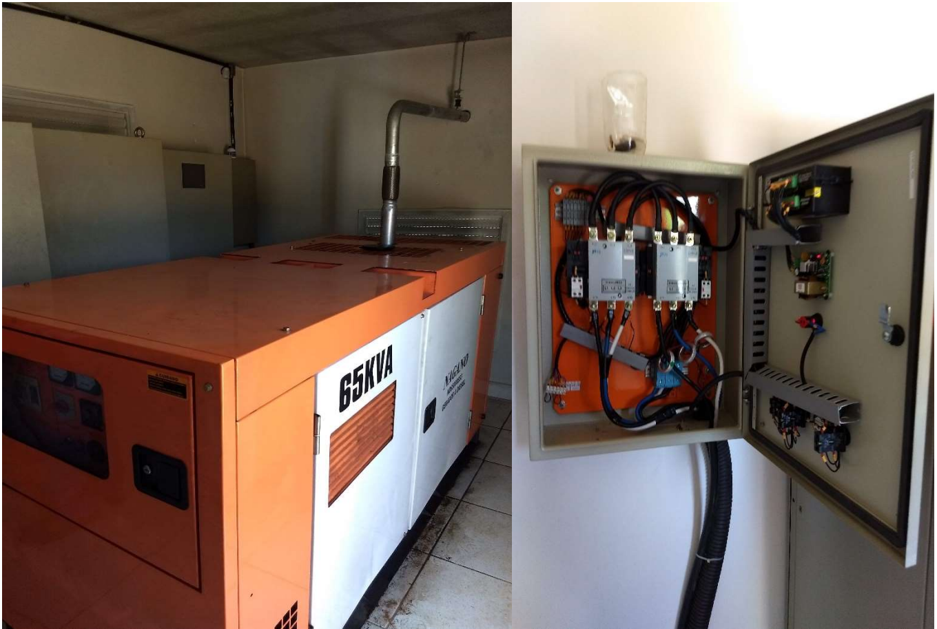
Figura 277: Estação Elevatória de Esgoto Bruto – EEEB Capela do Santo Antônio
