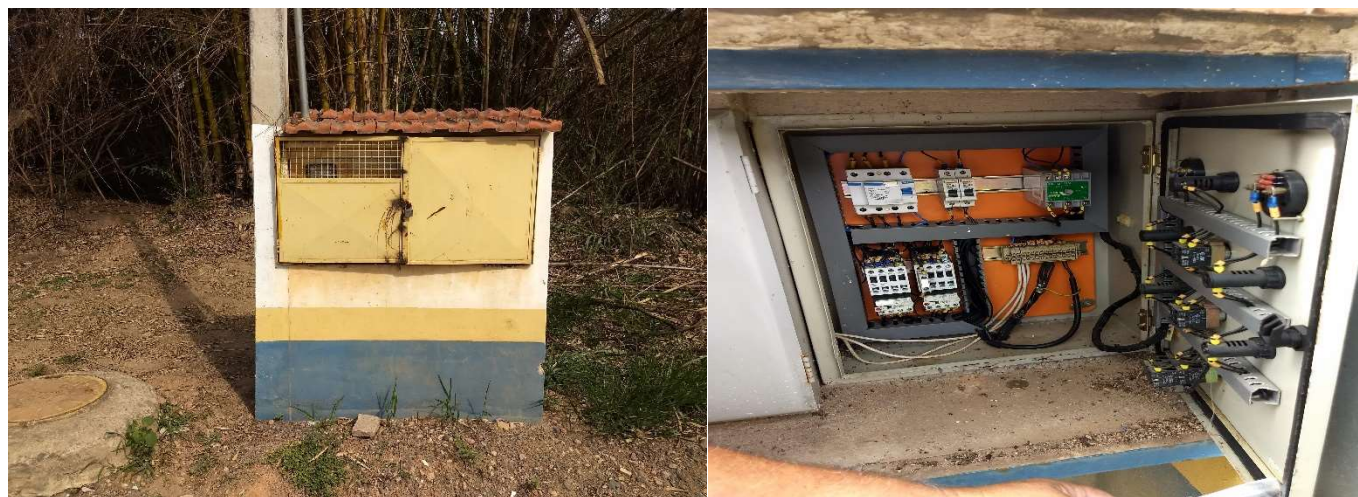
Figura 138: Estação Elevatória de Esgoto Bruto – EEEB Camanducaia.
