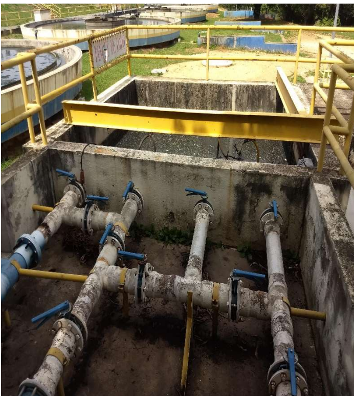
(a) Tanque de Lodo
