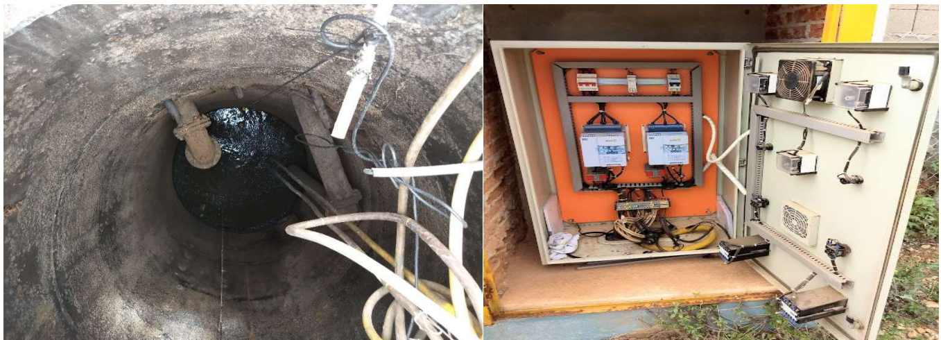
Figura 121: Estação de Elevatória de Esgoto Bruto – EEEB Jardim São Pedro..
