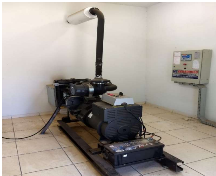
Figura 244: Estação Elevatória de Esgoto Bruto – EEEB 05 – Roseira de Cima.
