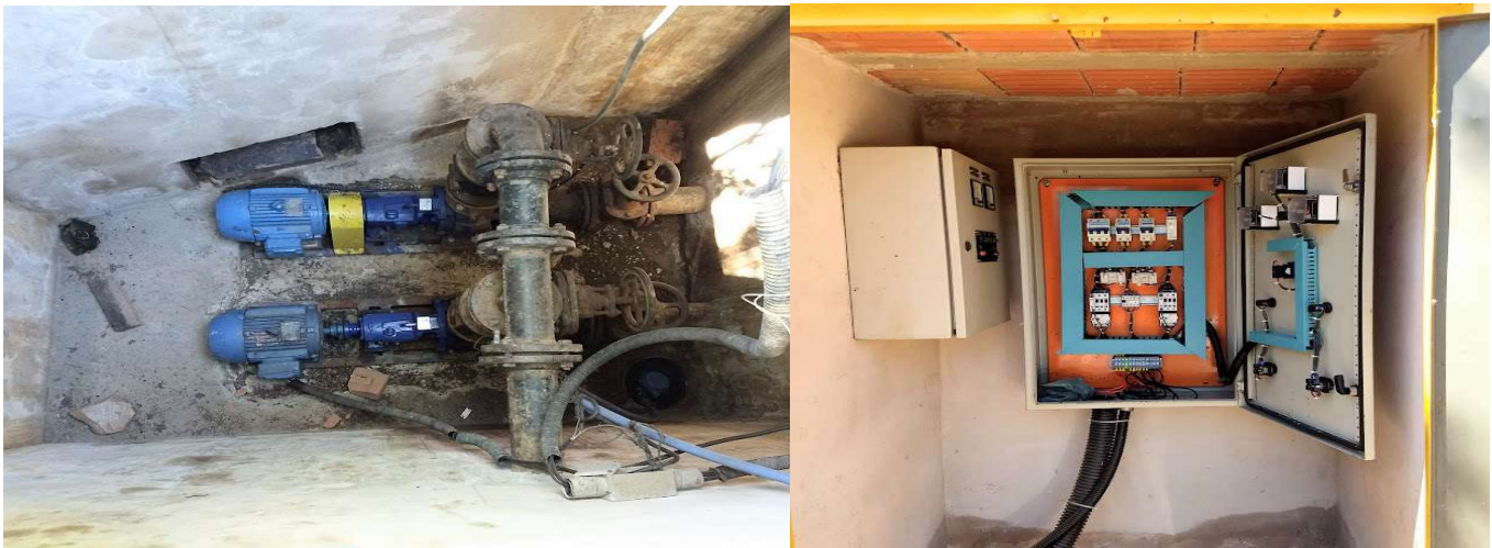
Figura 181: Estação Elevatória de Esgoto Bruto – EEEB Colina do Castelo I.
