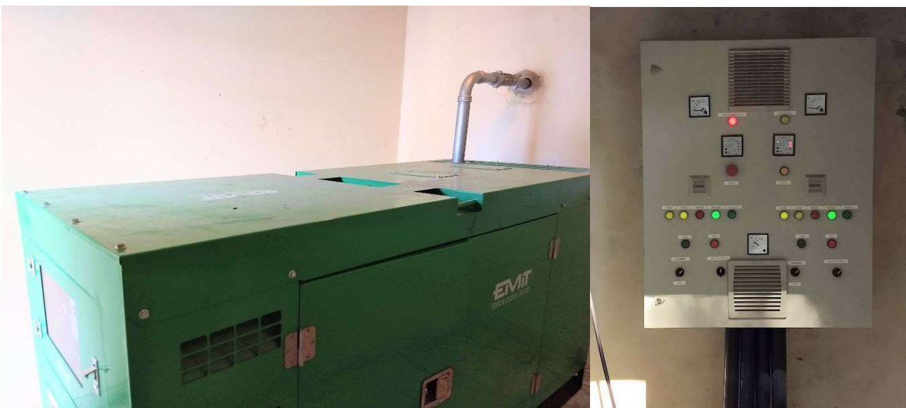
Figura 194: Estação Elevatória de Esgoto Bruto – EEEB 03C.
