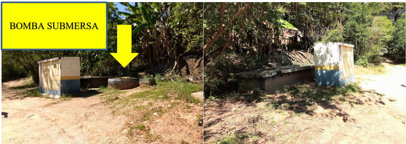
Figura 180: Estação Elevatória de Esgoto Bruto – EEEB Colina do Castelo I..
