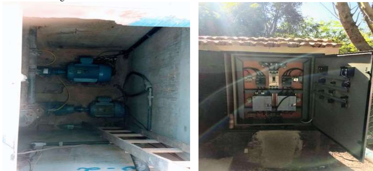
Figura 172: Imagem das Bombas KSB Megaflow 65-200k e Megaflow 50-200k.e painéis da Estação Elevatória de Esgoto Bruto - EEEB Chácaras Primavera.
