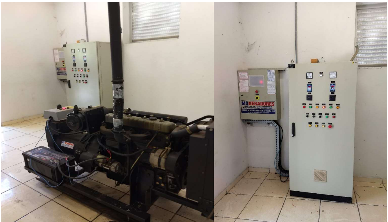
Figura 253: Estação Elevatória de Esgoto Bruto – EEEB 06 – Roseira de Baixo.
