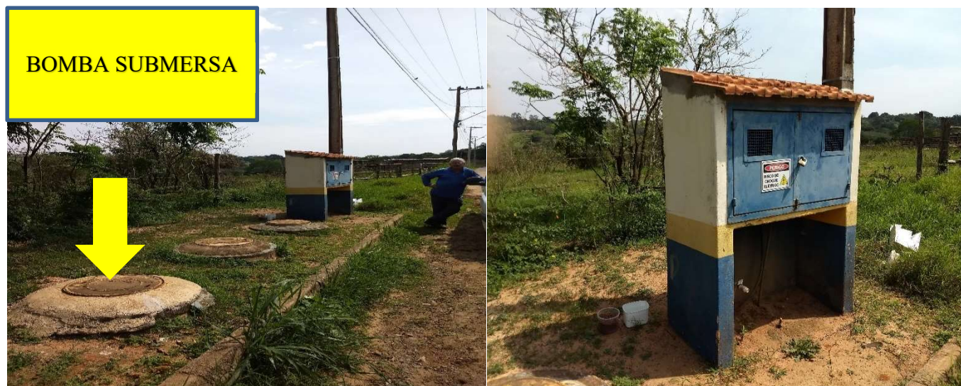
Figura 103: Estação Elevatória de Esgoto – Guedes III (EEE – Guedes III).
