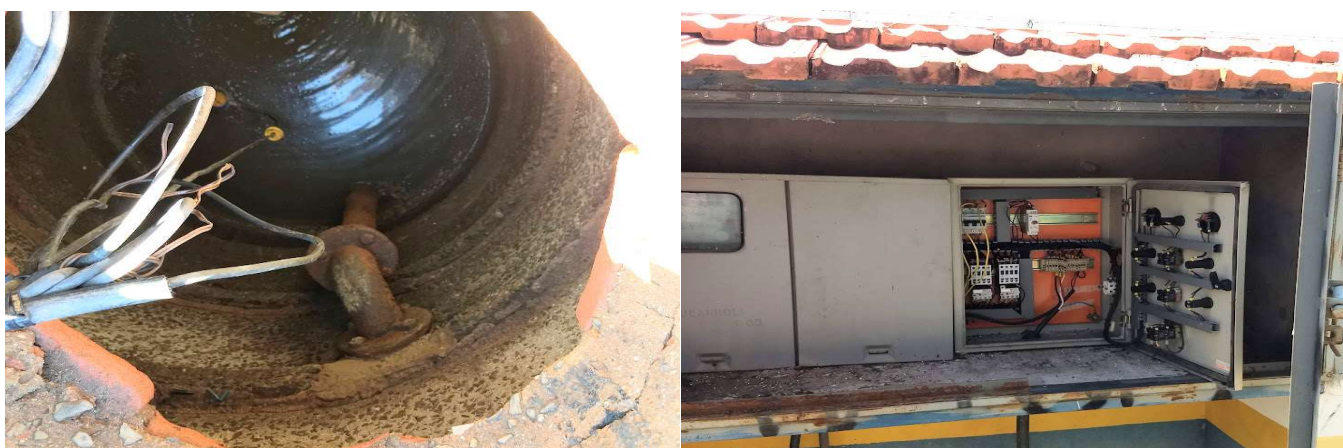
Figura 156: Estação Elevatória de Esgoto Bruto – EEEB Colina do Castelo III.
