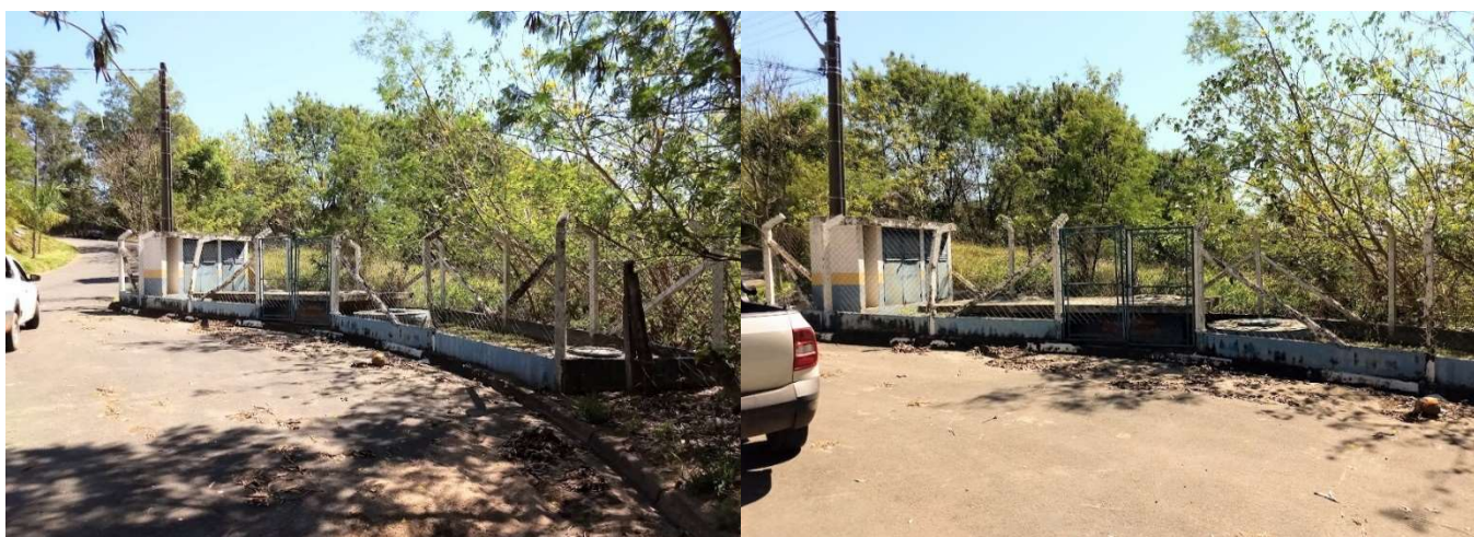
Figura 185: Estação Elevatória de Esgoto Bruto – EEEB Colina do Castelo II.
