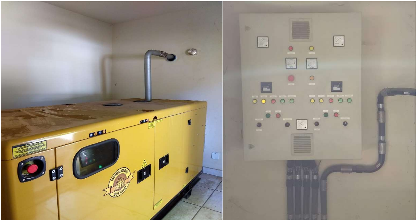
Figura 180: Estação Elevatória de Esgoto Bruto - EEEB 03A.
