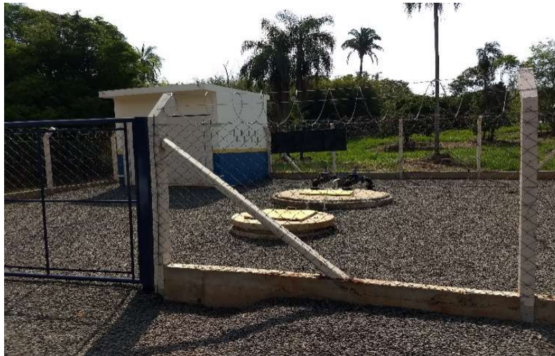
Figura 97: Estação Elevatória de Esgoto – Guedes I (EEE – Guedes I).
