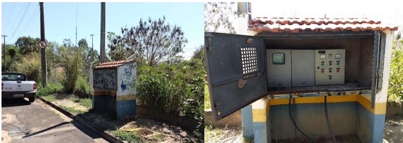
Figura 187: Estação Elevatória de Esgoto Bruto – EEEB Colina do Castelo III.
