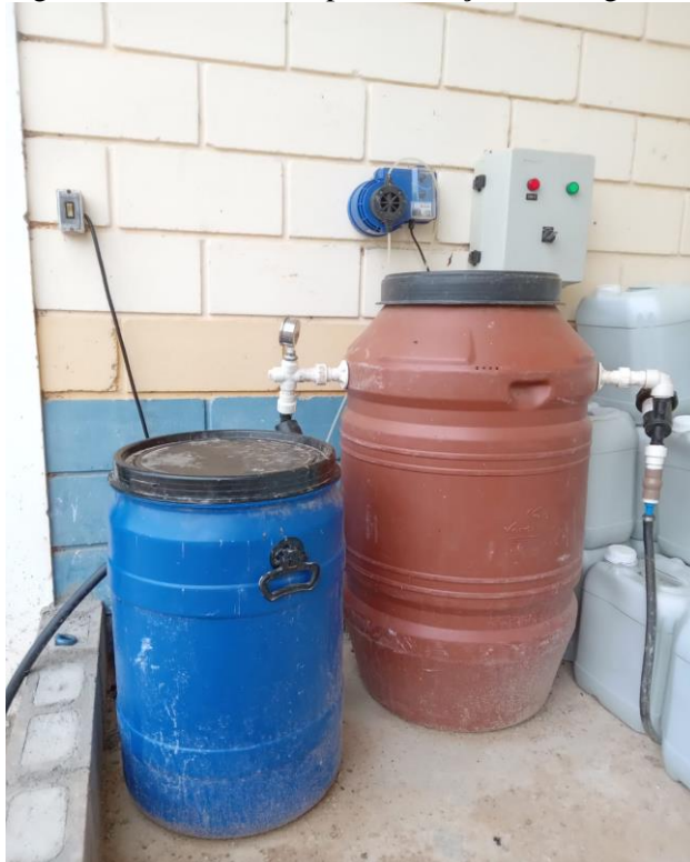
Figura 1: Sistema de Preparo, diluição e Dosagem
