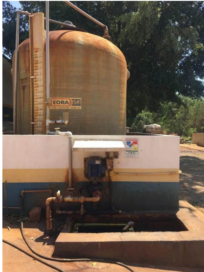
Figura 3. Situação atual da contenção do sistema de bombeamento do TQ.03.
