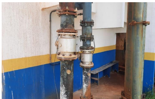
Medidores de vazão (elemento primário) Adutoras 200 e 150 mm
