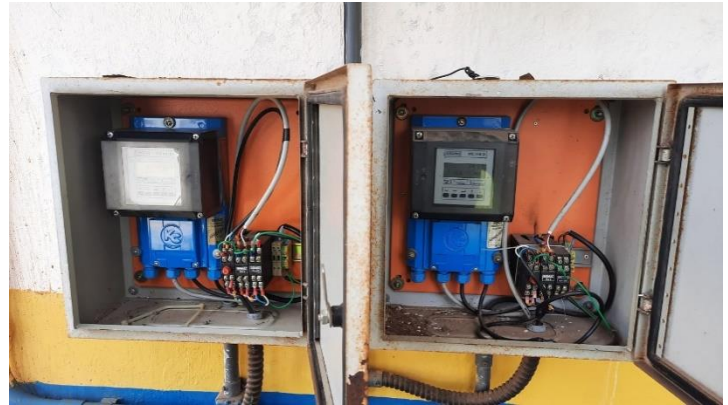
Conversor de sinal (display – elemento secundário) Adutoras 200 e 150 mm
