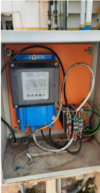
Conversor de sinal (display – elemento secundário) Adutora 300 mm
