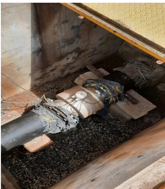
Medidor de vazão (elemento primário) Adutora 300 mm
