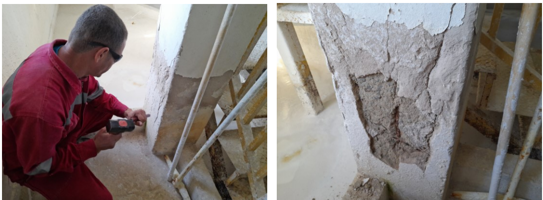
VISTA DA BASE DO PILAR DANIFICADO
