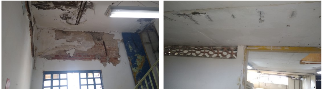
DETALHE DOS DANOS TÍPICOS IDENTIFICADOS
