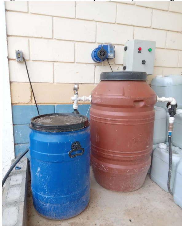
Figura 1: Sistema de Preparo, diluição e Dosagem
