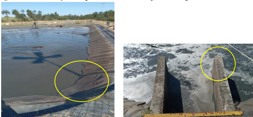
Figura 02: Ilustração da geomembrana rompida da lagoa 02
