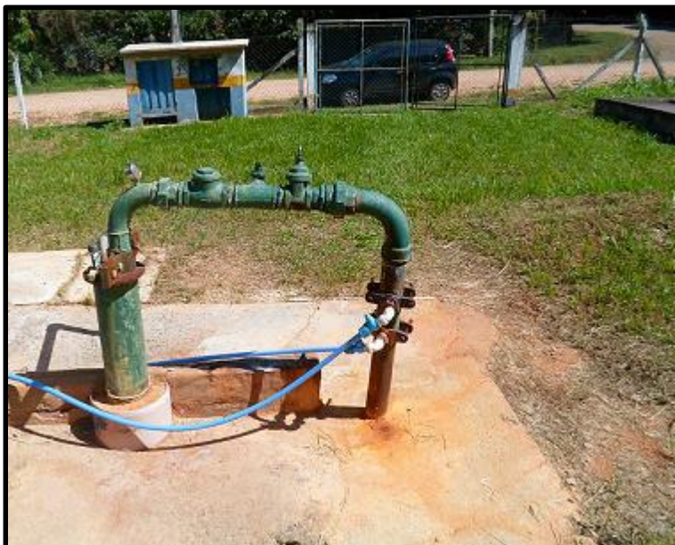
Figura 08 - Captação subterrânea no poço Santo Antônio.
