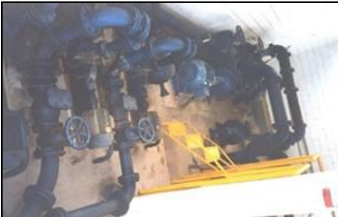
Figura 24 – Estação Elevatória de Água Potável do Nassif (à direita) e do Capotuna (à esquerda)
