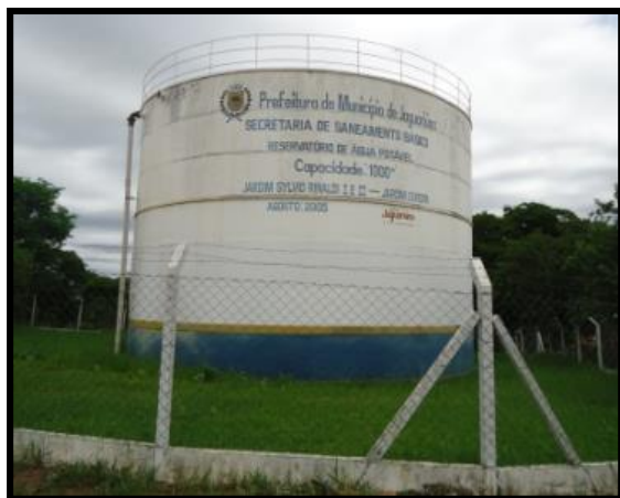
Figura 28 - Reservatório Sylvio Rinaldi I (1.000 m 3 ).
