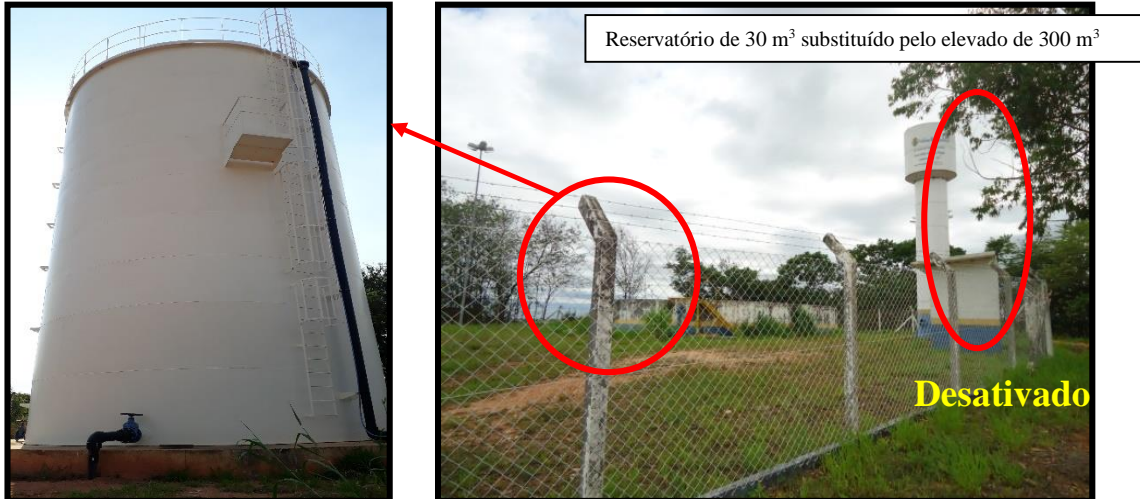
Figura 33 - Reservatórios Elevado Florianópolis II (300 m 3 ) que substituiu o Reservatório Elevado Florianópolis (30 m 3 ) - Terras do Capela
