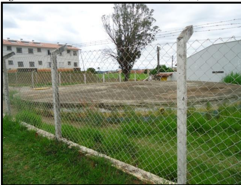
Figura 22 - Reservatório Cruzeiro do Sul (600 m 3 ).
