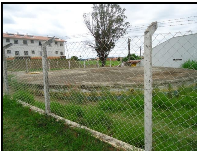
Figura 22 - Reservatório Cruzeiro do Sul (600 m 3 ).
