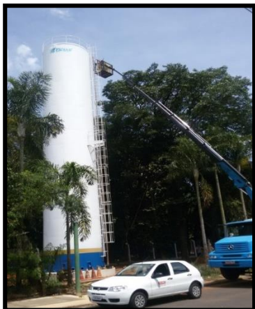
Figura 23 – Reservatório Roseira de Cima - (200 m 3 ).
