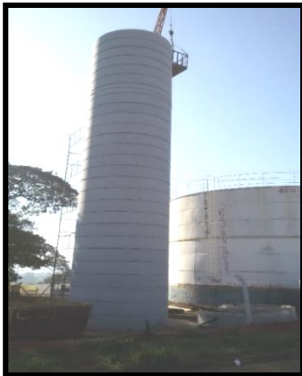
Figura 30 - Reservatório Sylvio Rinaldi II (125 m 3 ).
