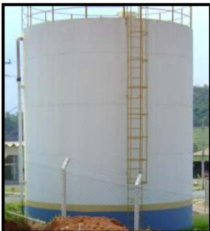
Figura 33 - Reservatório Elevado Pinheiros (200 m 3 ).
