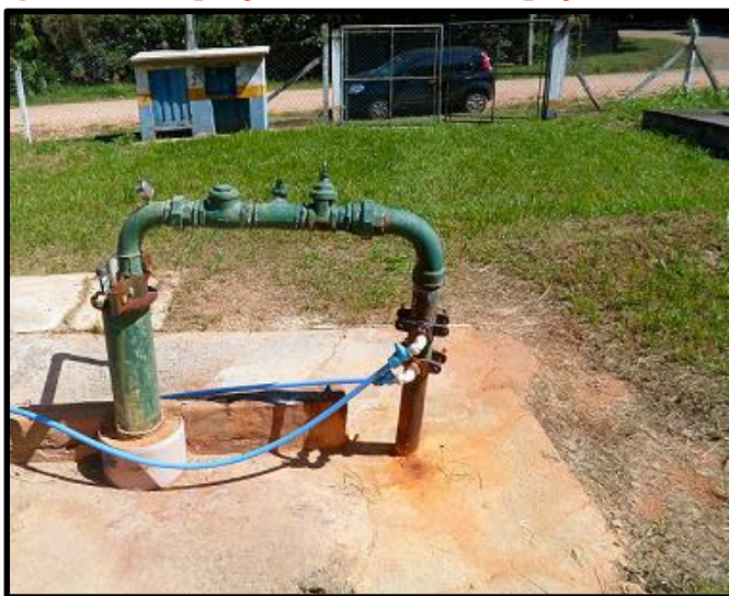
Figura 08 - Captação subterrânea no poço Santo Antônio.
