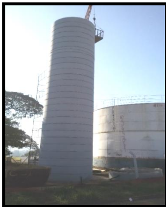
Figura 30 - Reservatório Sylvio Rinaldi II (125 m 3 ).
