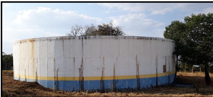
Figura 26- Reservatório Capotuna II (1.200 m 3 ) – novo implantado em 2018
