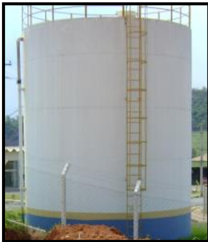
Figura 34 - Reservatório Elevado Pinheiros (200 m 3 ).
