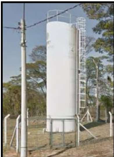
Figura 30 - Reservatório Zambom (100 m 3 ).
