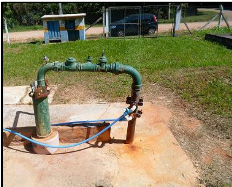
Figura 08 - Captação subterrânea no poço Santo Antônio.
